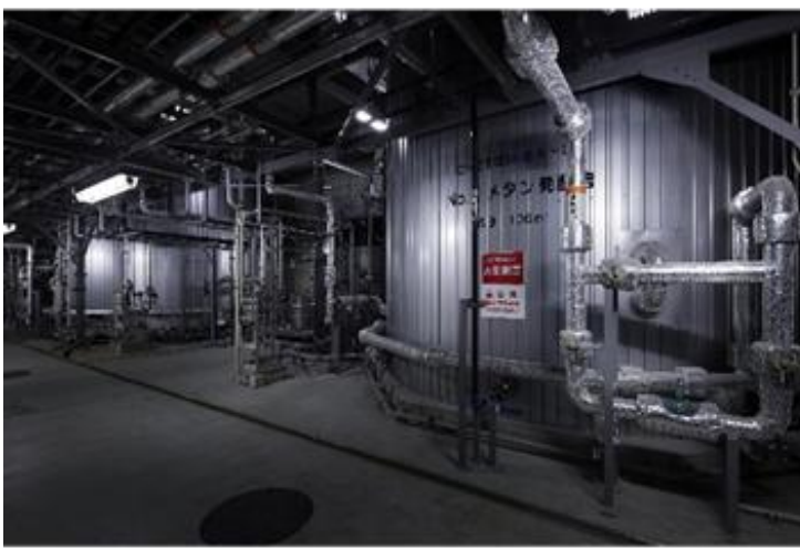
【バイオガス発生設備】
